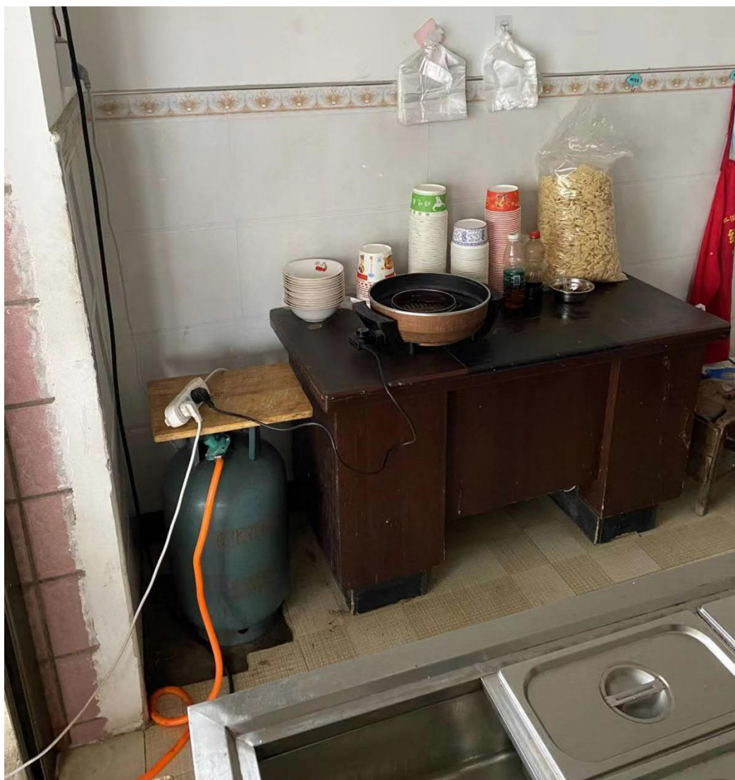
图5 用户端燃气软管
