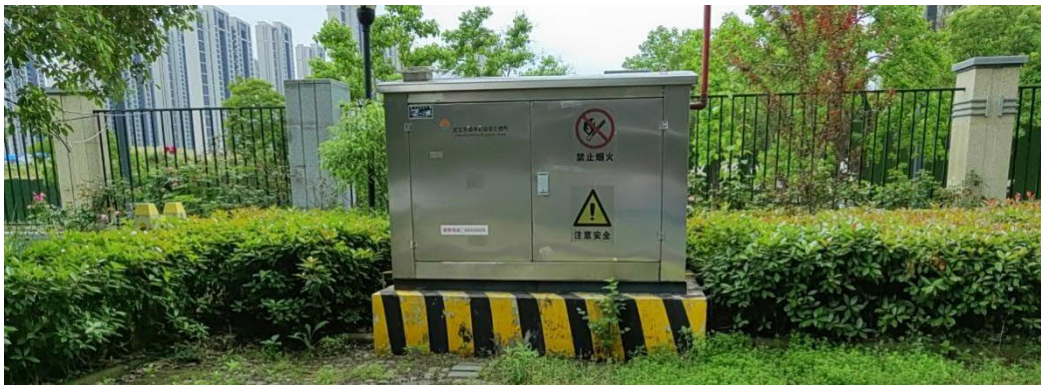
图3 左岭五期调压柜缺少防撞装置
