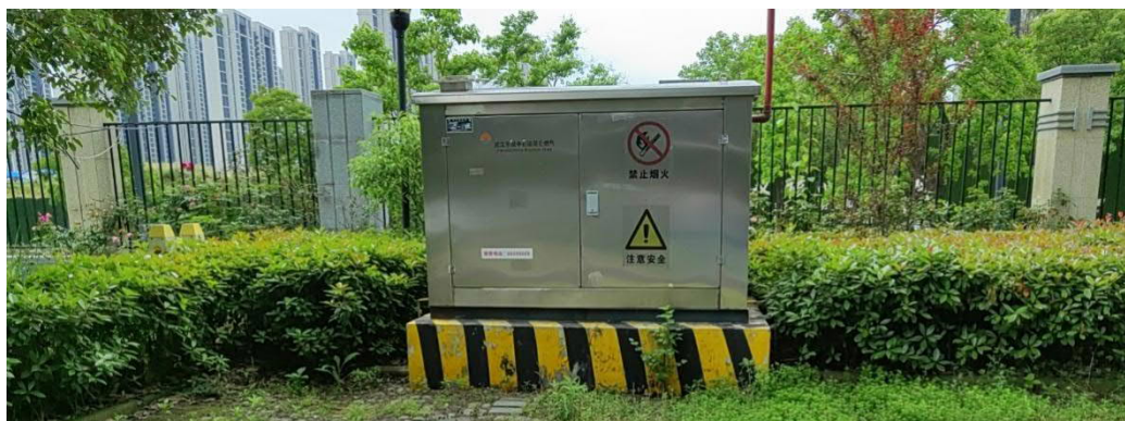
图 4.4-1 左岭五期调压柜缺少防撞装置
