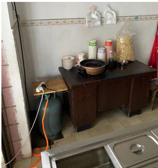
图 4.5-1 用户灶具使用橡胶软管
